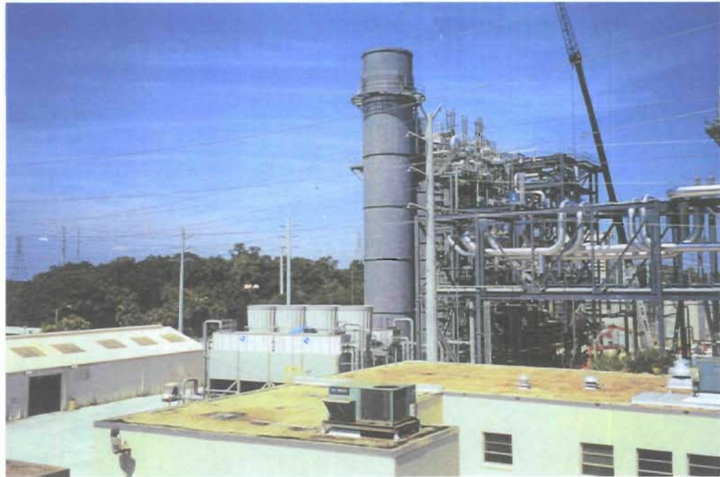
Typical HRSG Stack
