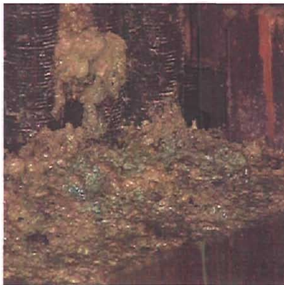
Figure 1-25 HRSG Sulfur Deposits
