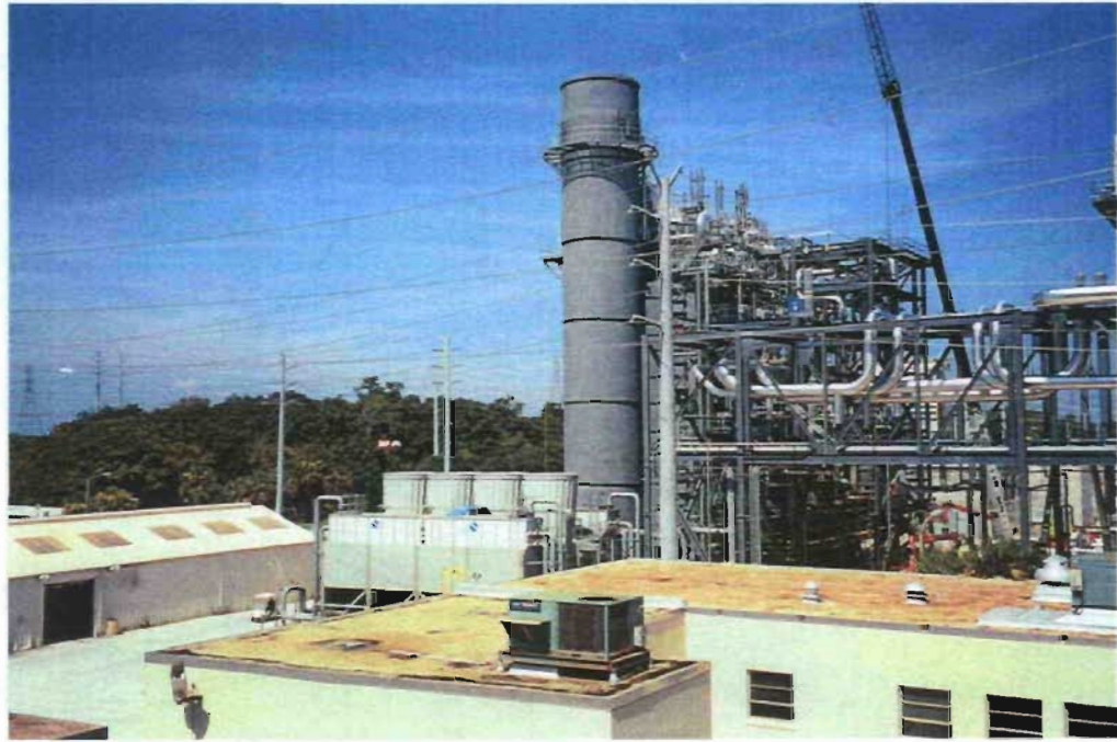
Typical HRSG Stack
