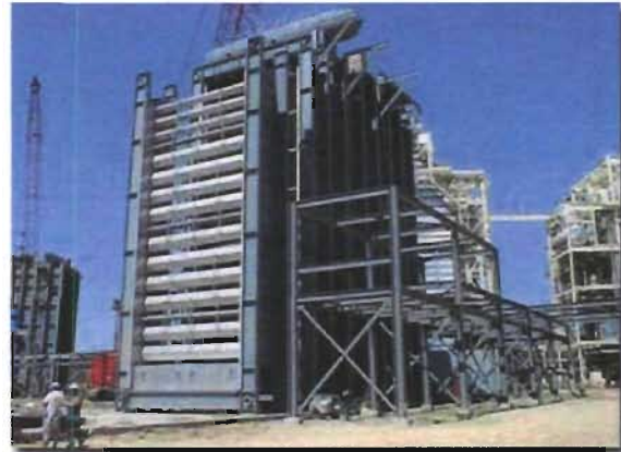
Figure 15 – Duct Burner and HRSG
