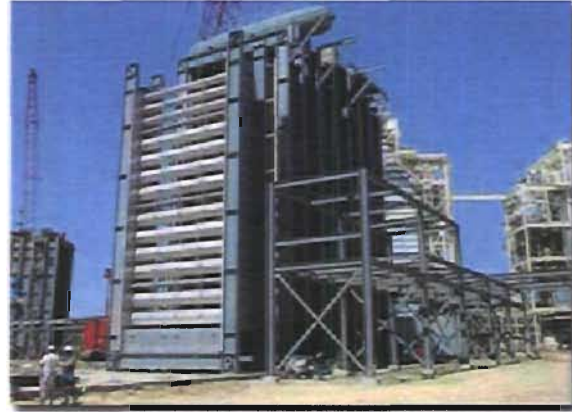
Figure 16 – Duct Burner and HRSG (Coen)
